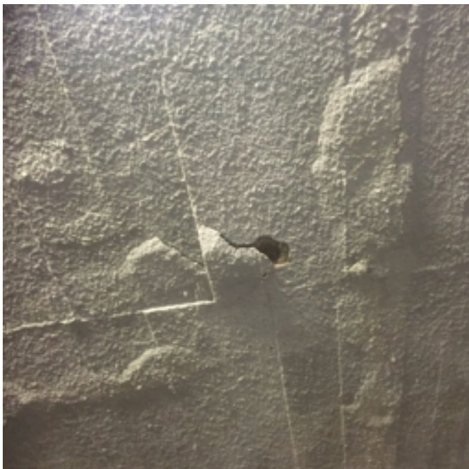
Spjälkning pga armeringskorrosion
